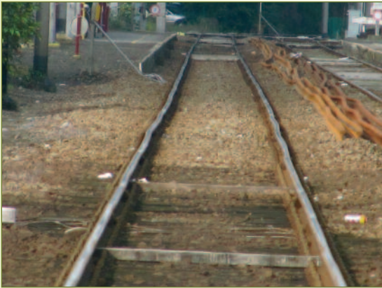
Impressie van de slechte toestand van spoor 1 in het station van Puurs, kijkend in de richting van St-Niklaas.
