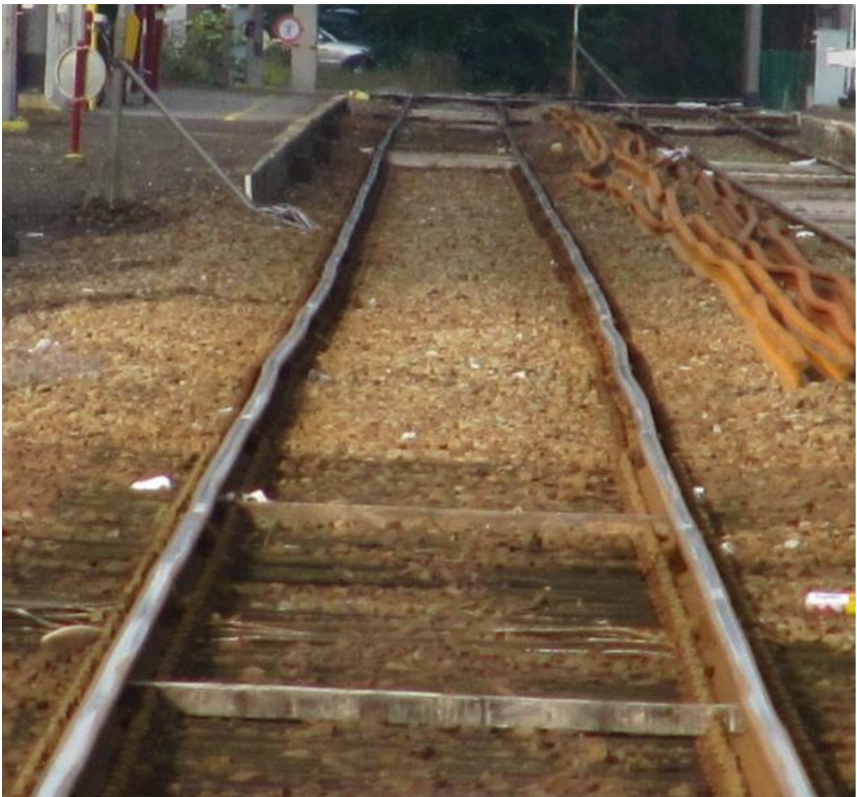
Impressie van de slechte toestand van spoor 1 in station Puurs, kijkend in de richting van St-Niklaas.
