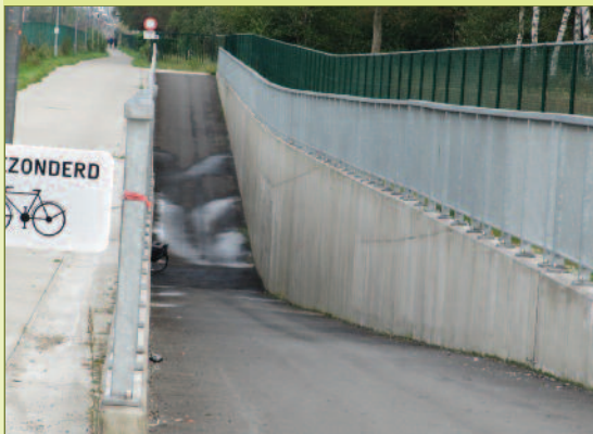
Fig. 1. Lekkende onderdoorgang met dode hoeken, Hoge Bokstraat Sint-Niklaas.
